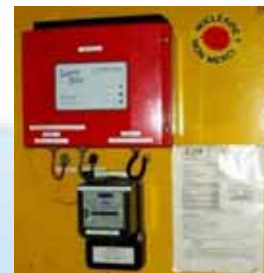
Onduleur SMA (Allemagne)
